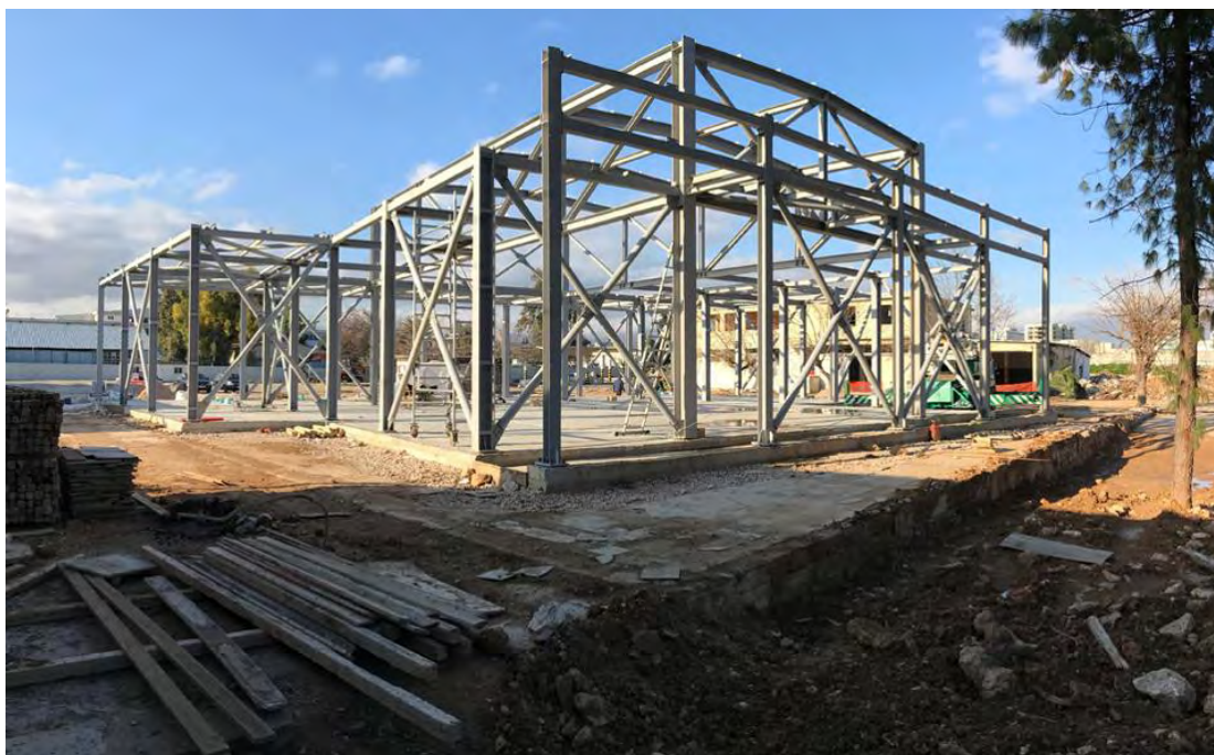
Εικόνα Β. 9.5.3. . Ο μεταλλικός σκελετός του Ισλαμικού Τεμένους στο Βοτανικό. Πηγή: Εφημερίδα "Η Καθημερινή"
